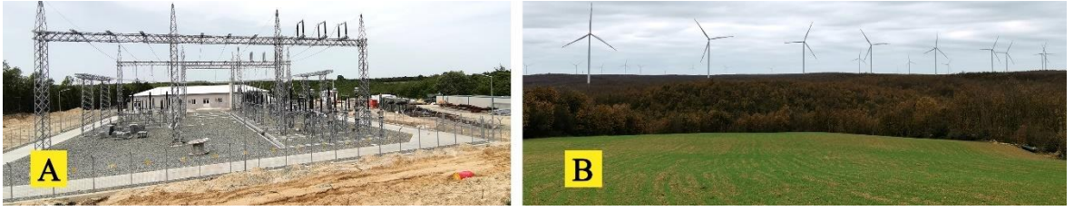
Şekil 16. Şile RES şalt merkezi ve rüzgâr türbinlerinin görünümü
