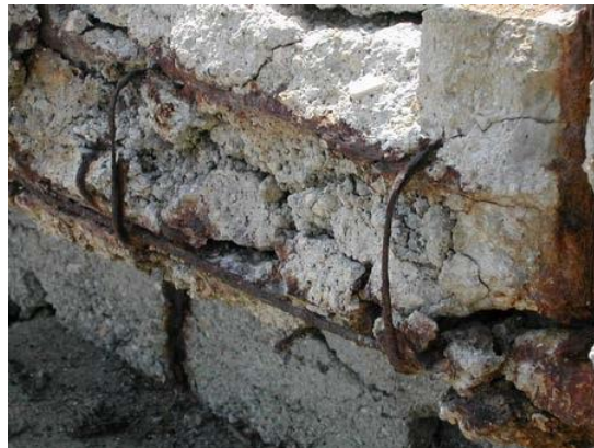
Şekil 4. Korozif aşınmaya örnek
