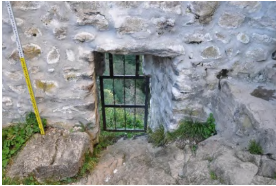
Res. 33. Tali Giriş Kapısı
